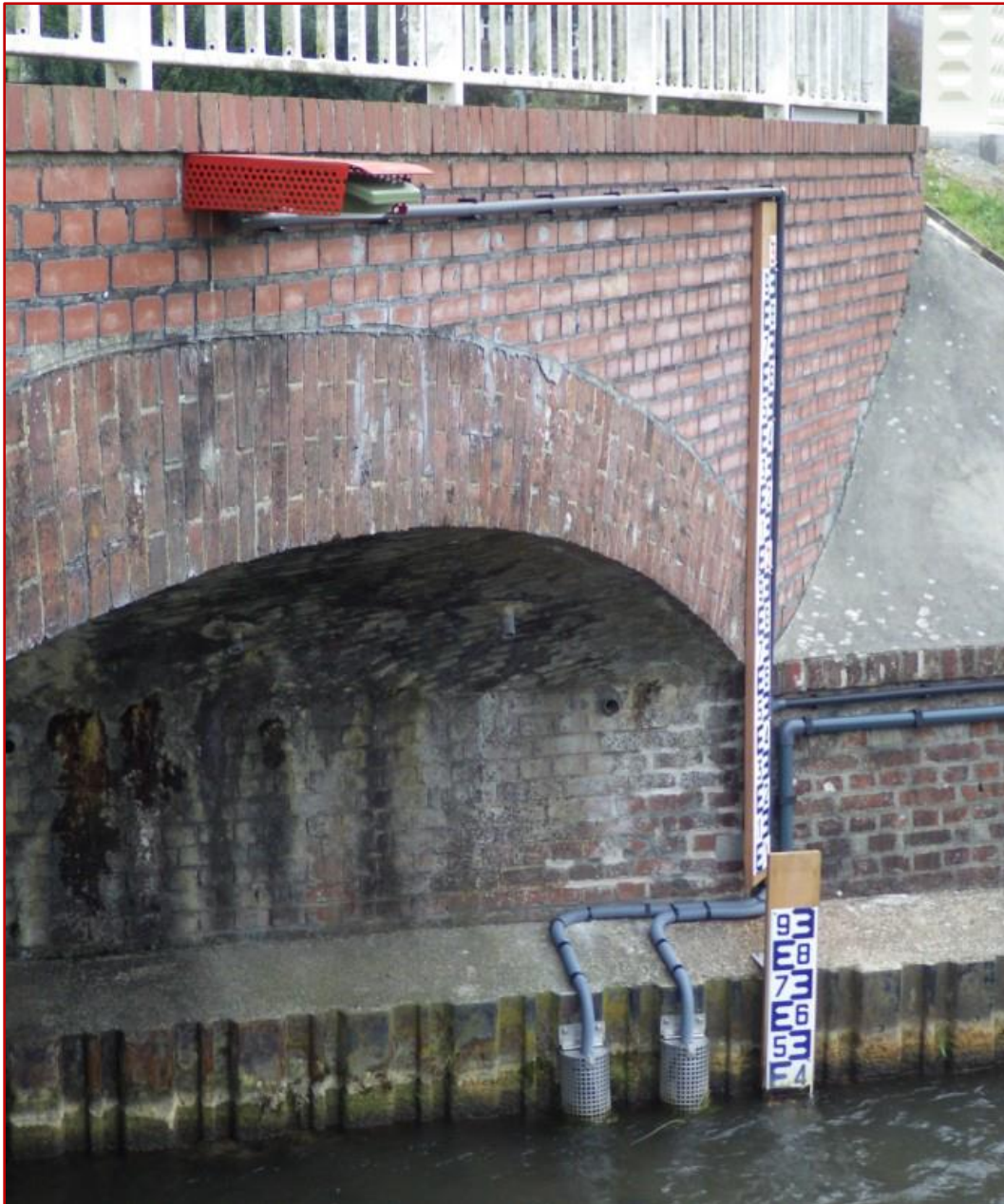
Station mise en place par un syndicat de bassin – double limnimétrie radar et bulle à bulle (crédit photo : L. Topin – SBV Saône, Vienne et Scie)
