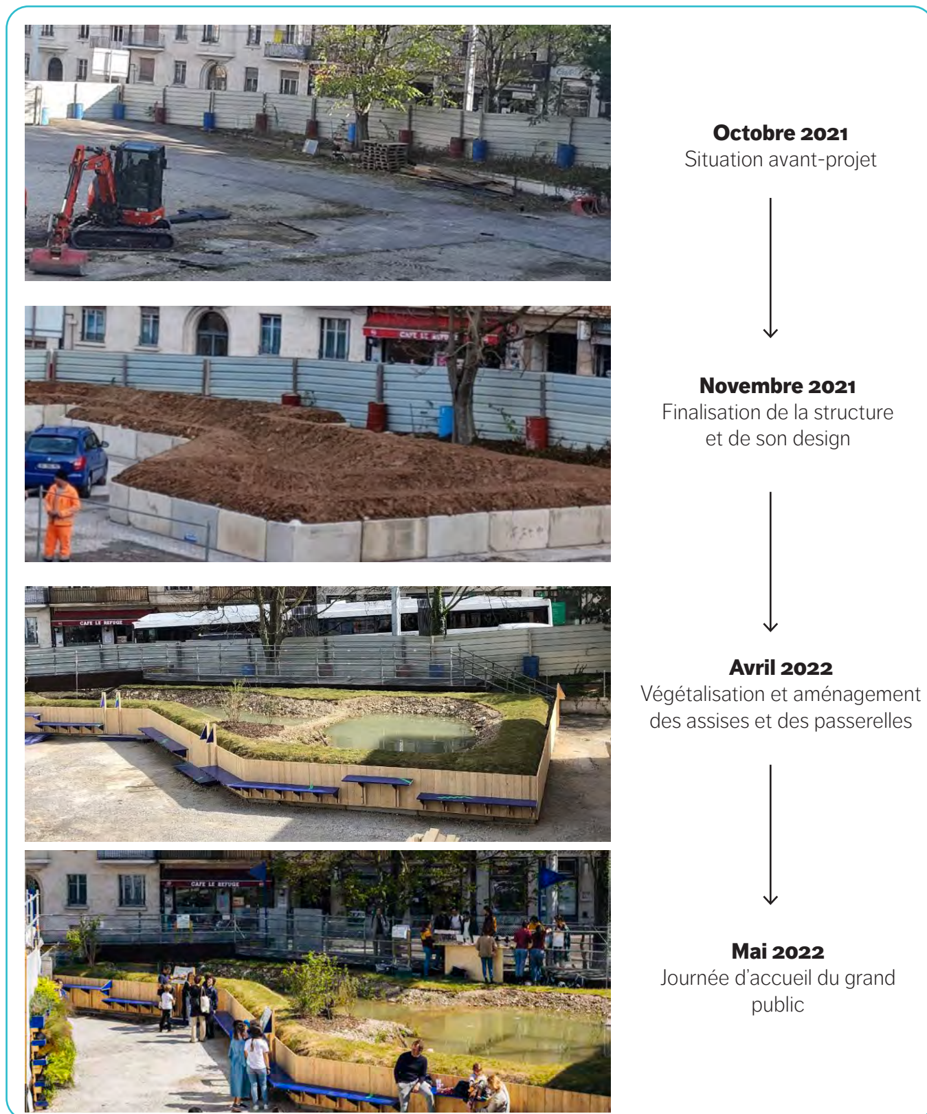
Figure 5. Les différentes étapes de l'aménagement de l'étang André Venturi, rue de la Prairie (HEPIA, Genève).
